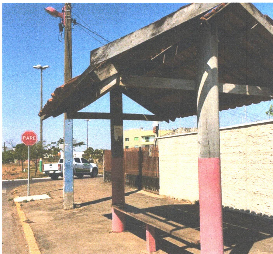
Figura 12 - Ponto de ônibus na Av. Jacarandás, esquina com Av. Flamboyants, necessita de reparo na cobertura.
