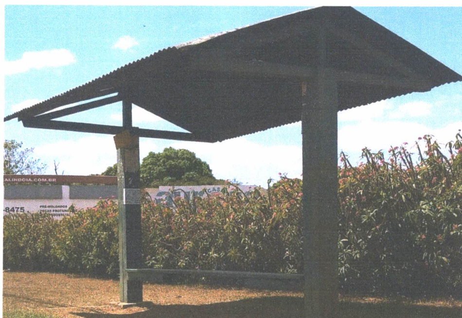
Figura 57 - Ponto de ônibus na Av. Foz do Iguaçu.
