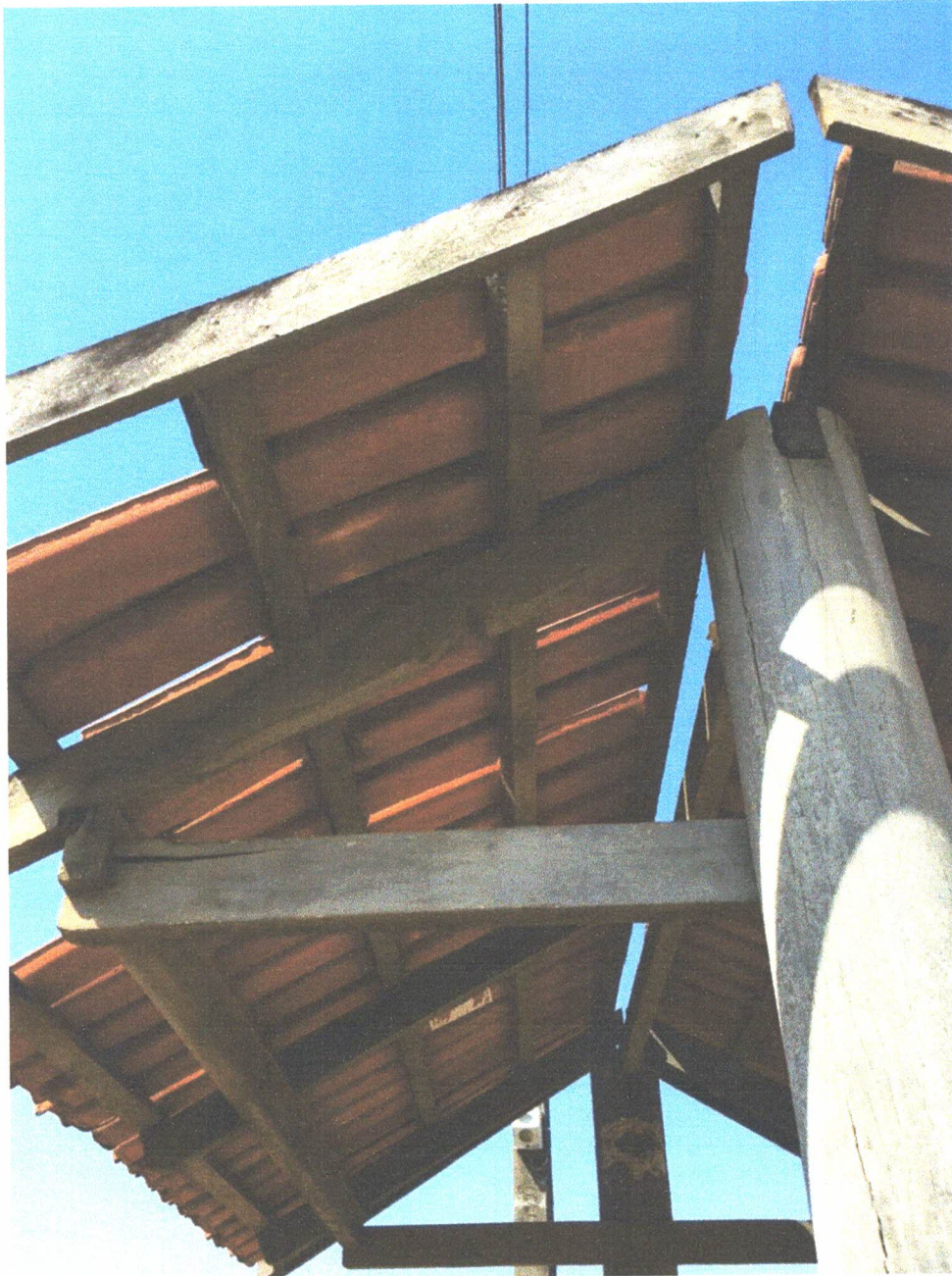
Figura 13 - Figura 12 - Ponto de ônibus na Av. Jacarandás, esquina com Av. Flamboyants, necessita de reparo na cobertura.
