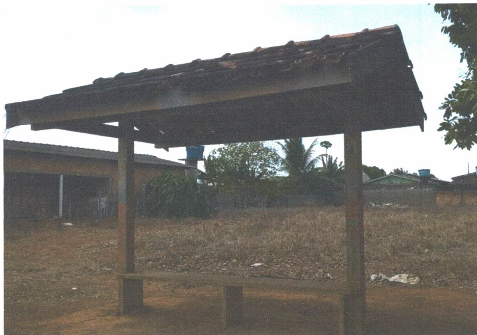
Figura 24 - Ponto de ônibus na Rua Paraná, próximo à casa nº 818, necessitando de reparo na cobertura.
