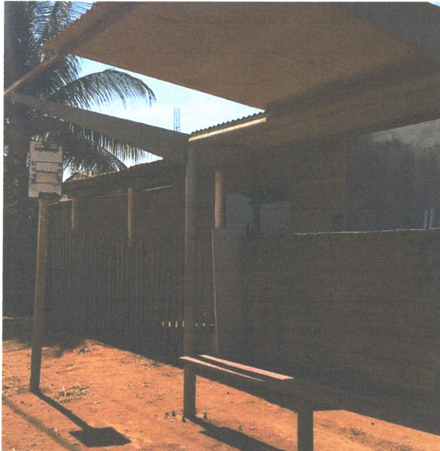
Figura 52 - Ponto de ônibus na Estrada Alzira, esquina com a Chácara São Cristóvão, necessitando de reparo na cobertura.
