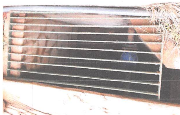
Figura 04 - Caixa que abriga o medidor de vazão sem proteção adequada. (Data: 12/11/2019)
