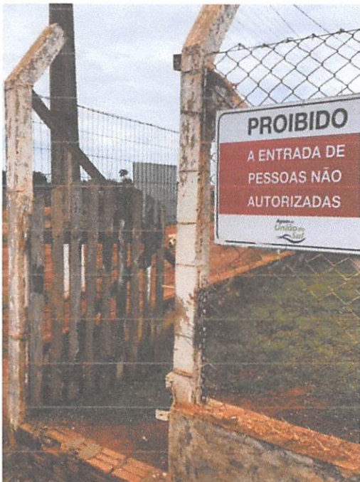
Figura 01 – Portão com baixa proteção a acesso de pessoas estranhas (Data: 12/11/2019)
