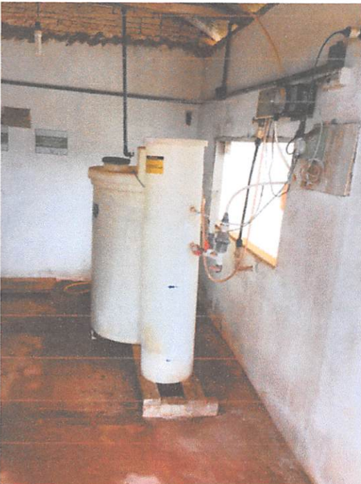
Figura 07 - Ausência de tanques de preparo de produtos químicos. NBR 12216/92 (Data: 12/11/2019)
