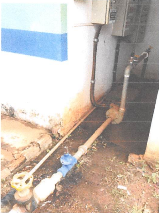
Figura 05 - Ausência de porta que impeça o acesso. NBR 12214/92 (Data: 12/11/2019)
