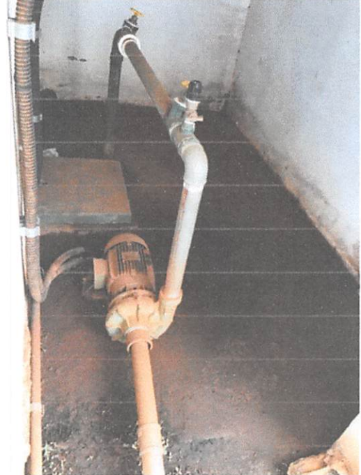
Figura 06 - Ausência de moto-bomba reserva (reserva quente) e drenagem- NBR 12214/92 (Data: 12/11/2019)
