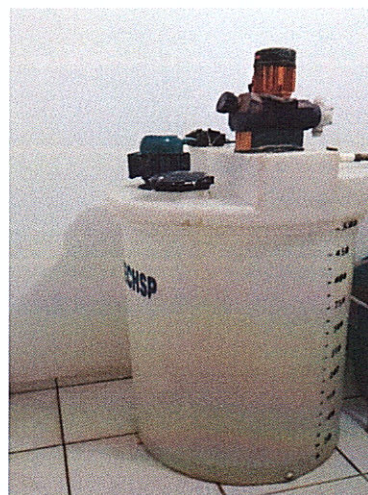
Figura 31. Instalação de dosadora e tanque agitador
