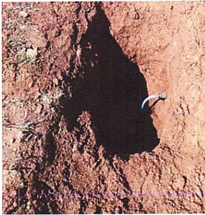
Figura 22. Vazamento em rede DN 60 mm
