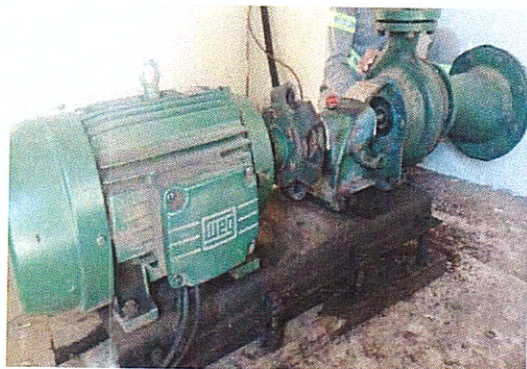
Figura 26. Antigo conjunto moto bomba
