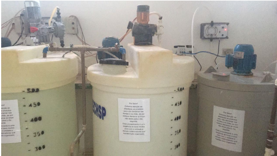
Figura 11 – Sistema de dosagem de produtos químicos.
