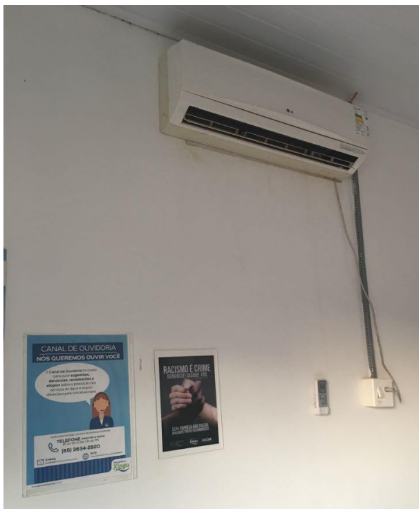
Figura 4 - Escritório de atendimento com ar condicionado.
