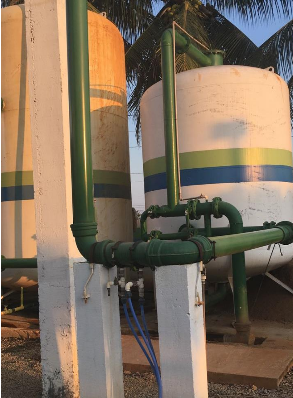
Figura 7 - Estação de Tratamento de Água do tipo compacta e pressurizada.
