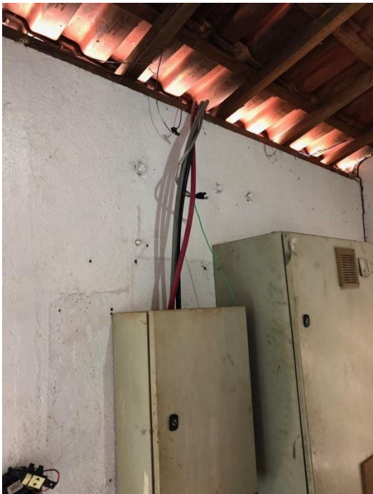
Figura 09 – Instalações elétricas fora do padrão NR 10 (Data: 10/10/2019)
