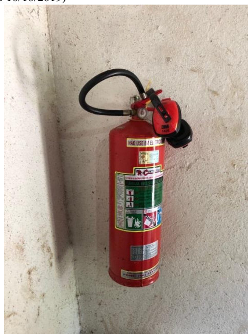
Figura 12 – Falta de sinalização do extintor de incêndios. NBR 12693/93 e NR 23 (Data: 10/10/2019)
