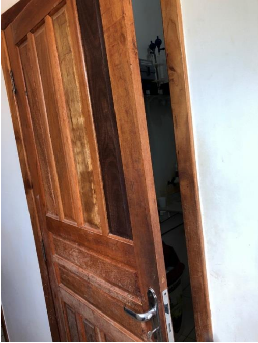
Figura 24 - Ausência de placa de restrição de uso e restrição de uso (Data: 10/10/2019)
