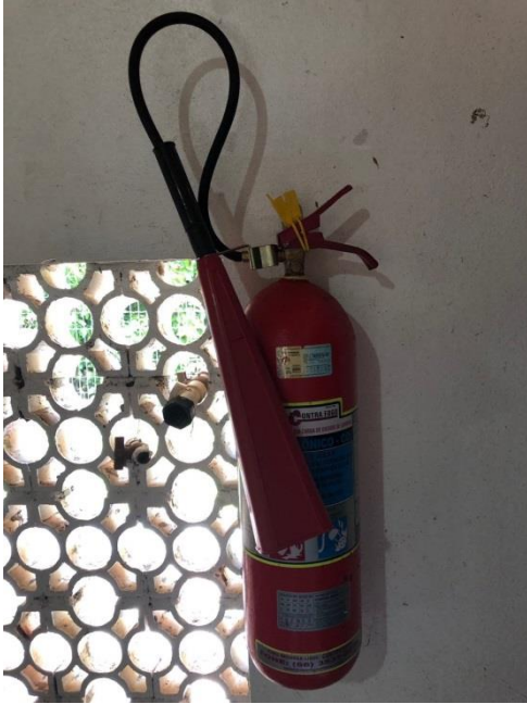
Figura 13 – Falta de sinalização do extintor de incêndios. NBR 12693/93 e NR 23 (Data: 10/10/2019)
