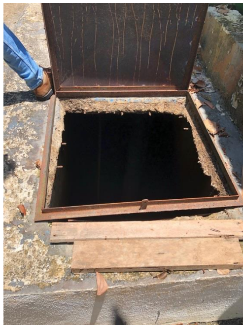
Figura 02 - Falha no isolamento e proteção da caixa de inspeção (Data: 10/10/2019)
