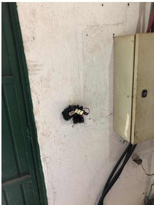
Figura 07 - Instalações elétricas fora do padrão NR 10 (Data: 10/10/2019)
