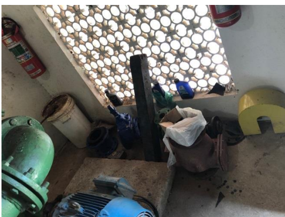
Figura 11 – Armazenagem inadequada de objetos em compartimento de instalações elétricas. NR 10 (Data: 10/10/2019)
