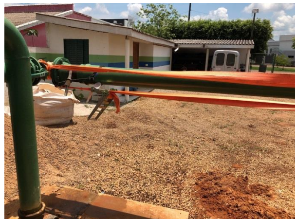
Figura 19 - Comprometimento das instalações hidráulicas NBR 12216/92 (Data: 10/10/2019)
