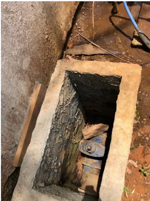
Figura 14 - Falta de proteção na caixa de registro na entrada do sistema de tratamento (Data: 10/10/2019)
