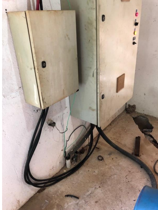
Figura 08 - Instalações elétricas fora do padrão NR 10 (Data: 10/10/2019)
