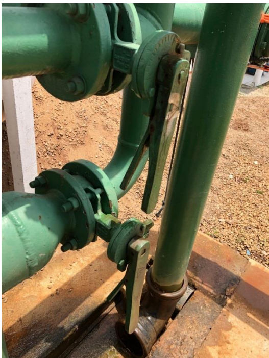
Figura 18 – Vazamento nos registros. Contrato de Concessão 096/14 (Data: 10/10/2019)
