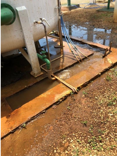
Figura 16 - Rede de drenagem de água insuficiente NBR 12216/92 (Data: 10/10/2019)
