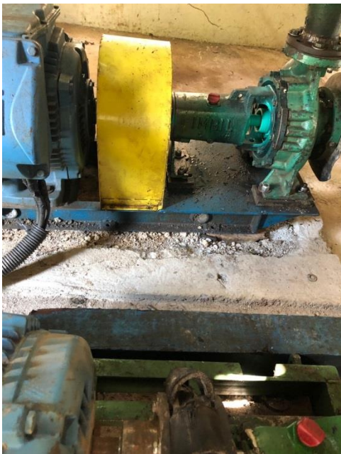
Figura 05 - Descarte incorreto de óleo lubrificante (Data: 10/10/2019)
