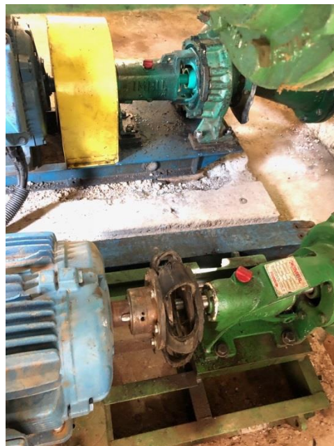
Figura 06 - Ausência de rede de drenagem de água de lubrificação de gaxetas NBR 12214/92 (Data: 10/10/2019)
