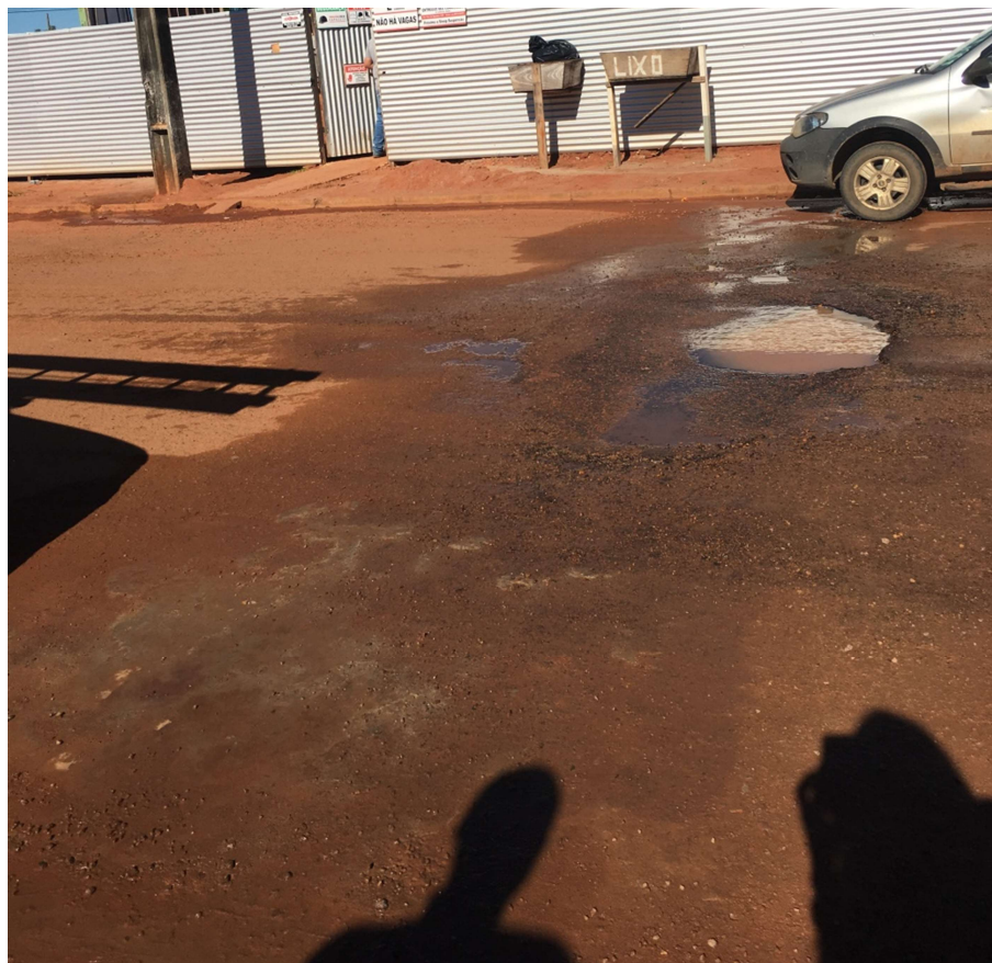
Figura 1 – Via danificada com buracos (Data: 25/04/2019).
