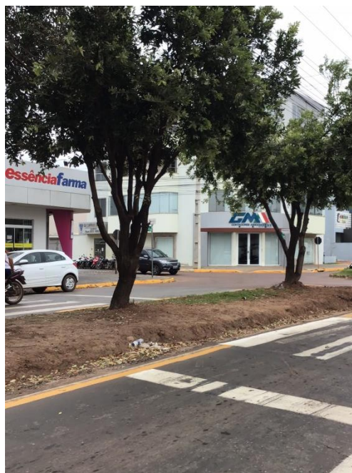
Figura 12 - Canteiro sem meio-fio no cruzamento com a Rua das Caviúnas (Data:15/05/2019).
