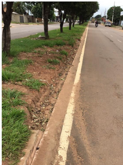
Figura 4 - Canteiro sem meio-fio próximo ao cruzamento com a Rua dos Marupás (Data: 15/05/2019).
