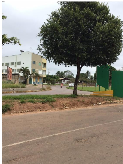
Figura 7 - Canteiro sem meio-fio no cruzamento com a Av. dos Flamboyants (Data: 15/05/2019).
