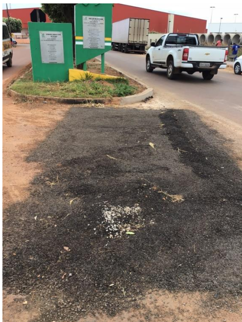
Figura 1 – Reparo de má qualidade no cruzamento da Av. Jacarandás e Perimetral Sul (Data: 15/05/2019).
