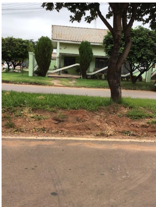
Figura 6 - Canteiro sem meio-fio em frente à residência de número 1637 (Data: 15/05/2019).
