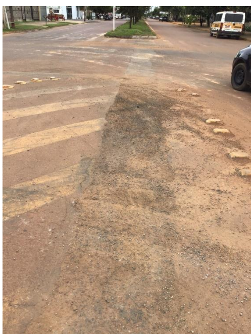
Figura 2 - Reparo de má qualidade no cruzamento da Av. Jacarandás e Perimetral Sul (Data: 15/05/2019).
