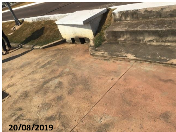
2- Rede de drenagem
