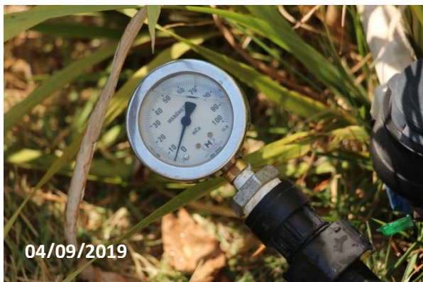
4- Registro da pressão na residência na Rua das Zínias, 89.
