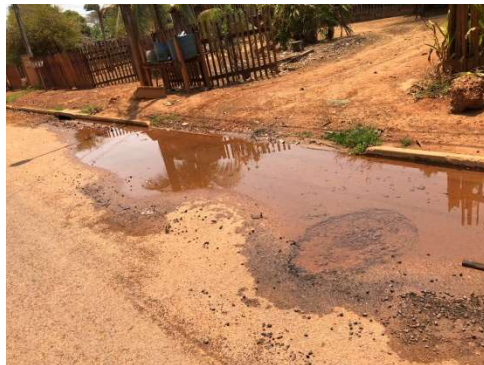
Figura 3 – Extensão do vazamento comprometendo o asfalto e indo direto ao bueiro (Data: 23/09/2019).
