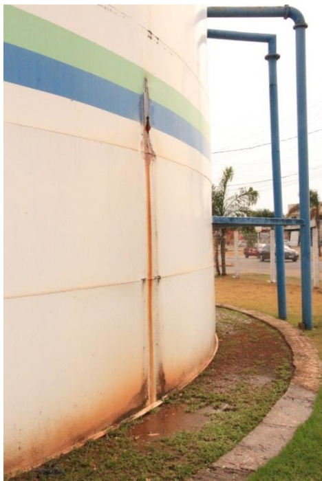
Figura 22 - Vazamentos no reservatório. Contrato de Concessão 096/2014 (Data: 26/09/2019)
