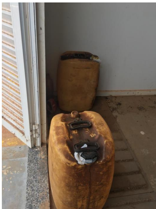
Figura 61 - Armazenagem inadequada de objetos em compartimento de instalações elétricas. NR 10 (Data: 25/10/2019)
