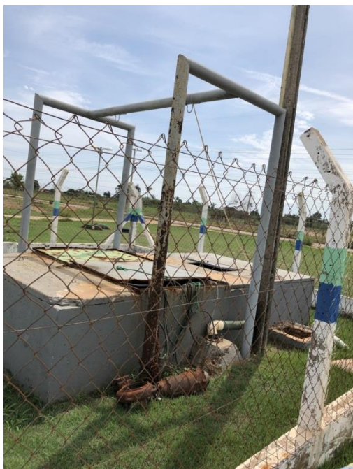
Figura 73 - Marcas de corrosão na estrutura física. NBR 12208/92 (Data: 25/10/2019)
