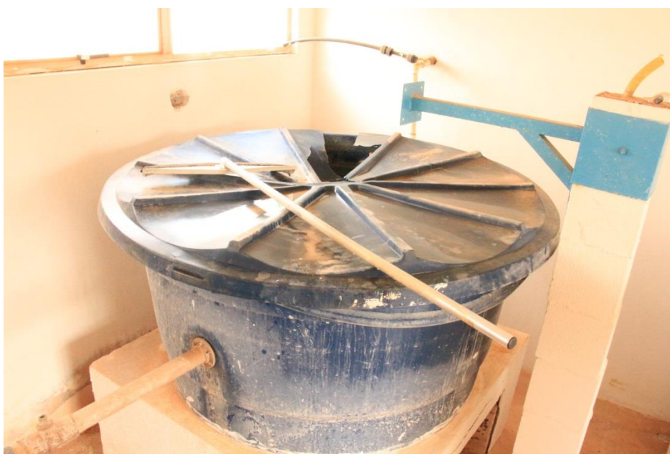
Figura 27 - Tanque de mistura com tampa quebrada e armazenagem inadequada de utensílios de Limpeza. NBR 12216/92 (Data: 26/09/2019)
