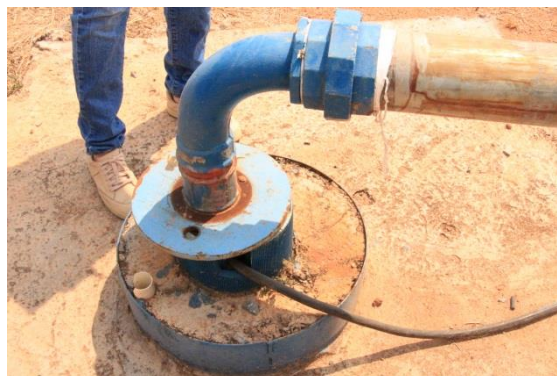
Figura 6 – Ausência do tubo medidor de nível no PTP 38 NBR 12212/92 (Data: 25/09/2019).
