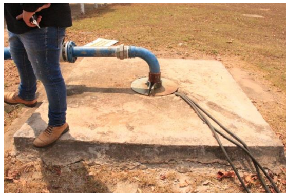
Figura 8 – Ausência do tubo medidor de nível no PTP 03. NBR 12212/92 (Data: 25/09/2019).
