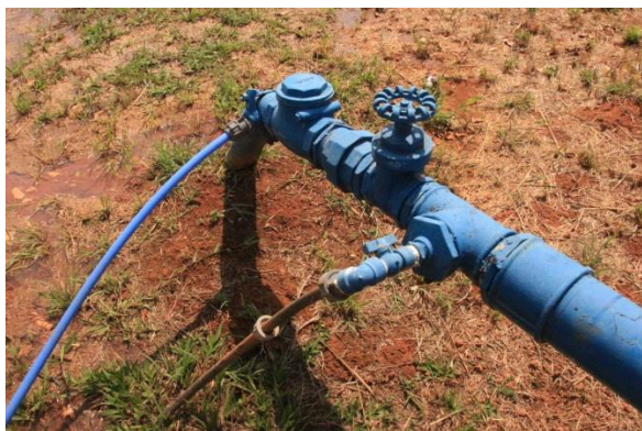
Figura 45 - Vazamento na saída do poço. Contrato de Concessão 096/2014 (Data:30/09/2019)
