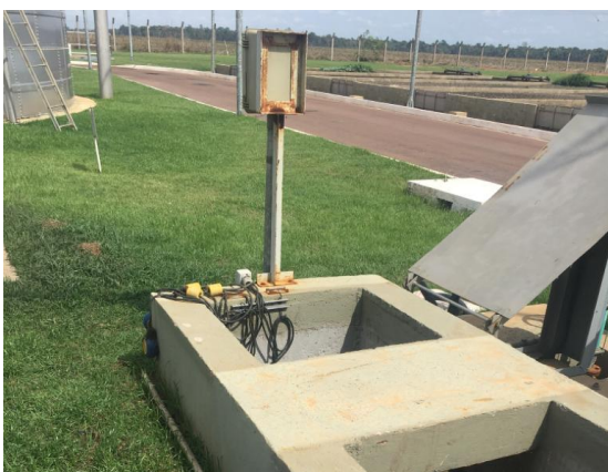
Figura 64 - Falha na proteção das instalações elétrica. NR 10 (Data: 25/10/2019)
