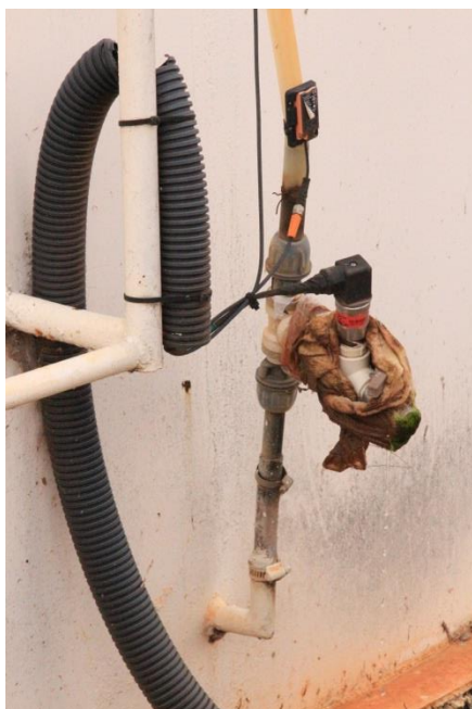
Figura 30 - Vazamento na torneira de coleta do reservatório. Contrato de Concessão 096/2014 (Data: 26/09/2019)
