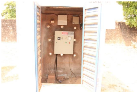
Figura 7 – Armazenagem inadequada de objetos em compartimento de instalações elétricas. NR 10 (Data: 25/09/2019).
