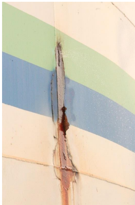
Figura 23 - Vazamentos no reservatório. Contrato de Concessão 096/2014 (Data: 26/09/2019)
