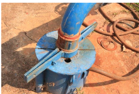
Figura 3 – Ausência do tubo medidor de nível no PTP 42 NBR 12212/92 (Data: 25/09/2019).
