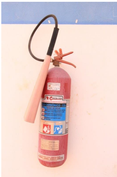
Figura 49 - Falta de sinalização do extintor de incêndios - NBR 12693/93 e NR 23 (Data: 30/09/2019)
