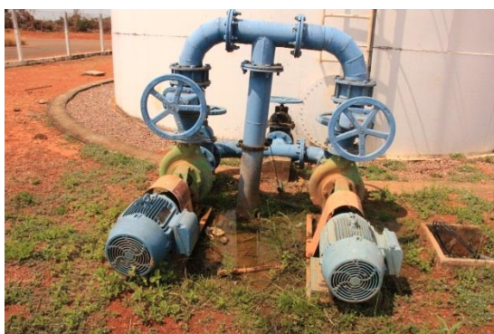
Figura 51 - Drenagem inadequada de água de lubrificação de gaxetas. NBR 12214/92 (Data: 30/09/2019)
