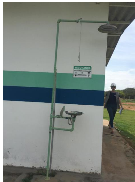
Figura 72 - Chuveiro lava-olhos não está localizado nas proximidades do laboratório. NBR 12216/92 (Data: 25/10/2019)
