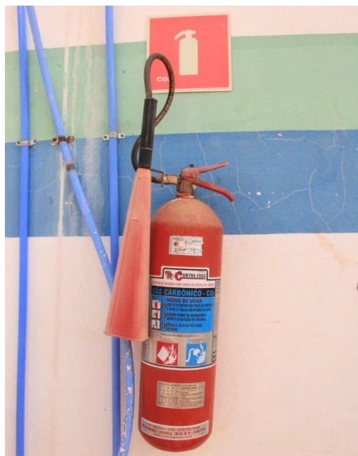
Figura 41 - Extintor em desconformidade com a norma. NR 23 (Data:30/09/2019)
