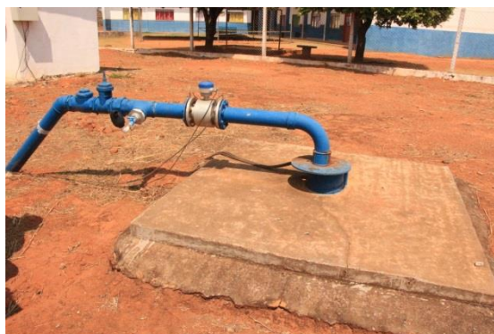
Figura 50 - Ausência do tubo de medição de nível. NBR 12212/92 (Data: 30/09/2019)
