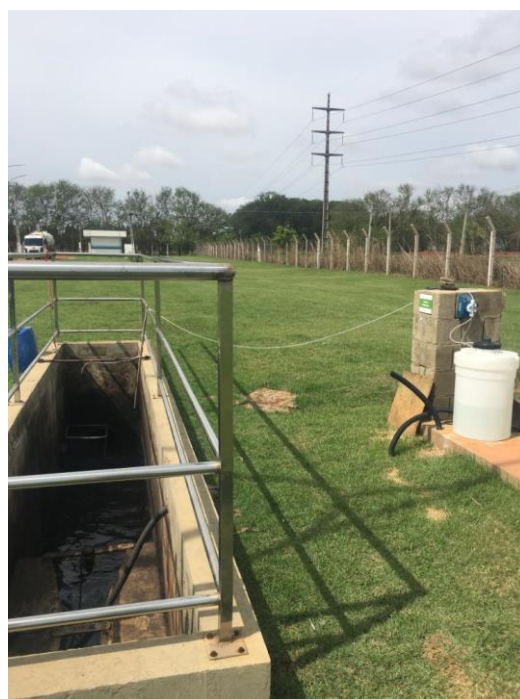
Figura 69 - Instalação inadequada de dosadora de produtos químicos – NBR 12216/92 (Data: 25/10/2019)
