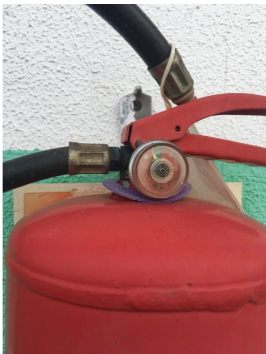
Figura 56 - Extintor despressurizado, sem lacre e trava de segurança. NBR 12962/98 (Data: 25/10/2019)
