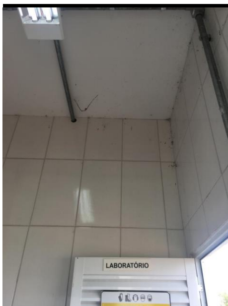
Figura 71 - Conservação e limpeza do ambiente comprometida. (Data: 25/10/2019)
