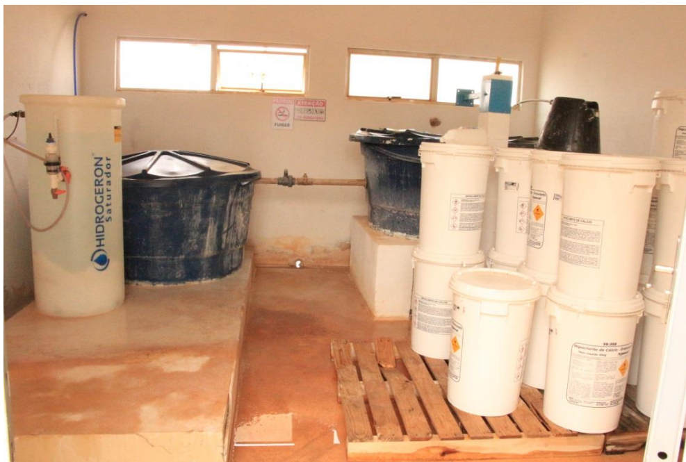
Figura 26 - Armazenamento inadequado dos produtos químicos. NBR 12219-96 (Data: 26/09/2019)
