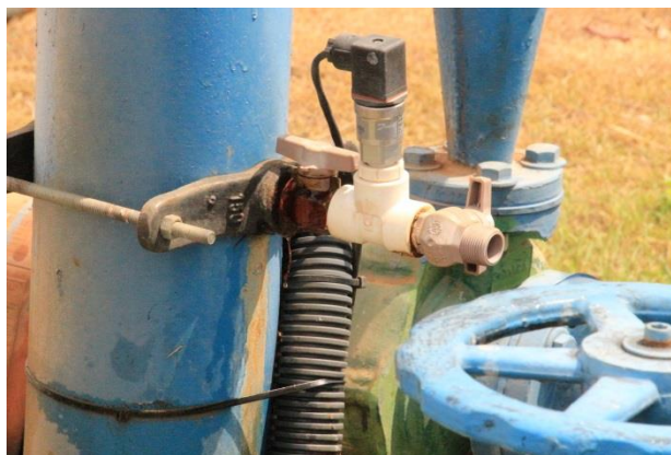
Figura 34 – Vazamento na torneira de saída de rede. Contrato de Concessão 096/2014 (Data: 26/09/2019)
