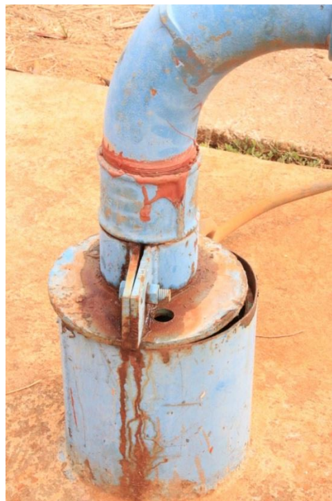
Figura 29 – Ausência do tubo de medição de nível. NBR 12212/92 e Vazamento e corrosão no poço. Contrato de Concessão 096/2014 (Data: 26/09/2019)
