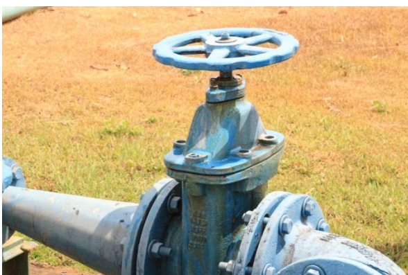
Figura 35 – Vazamento no registro. Contrato de Concessão 096/2014 (Data: 26/09/2019)
