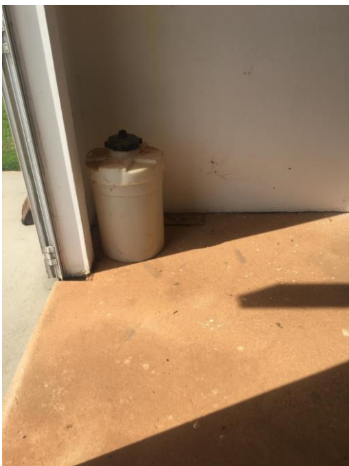
Figura 58 - Armazenagem inadequada de objetos em compartimento de instalações elétricas. NR 10 (Data: 25/10/2019)
