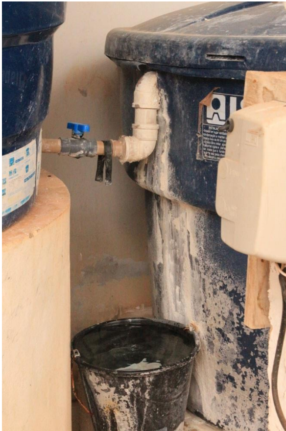
Figura 20 - Vazamento no tubo conector dos tanques de mistura. Contrato de Concessão 096/2014 (Data: 26/09/2019)
