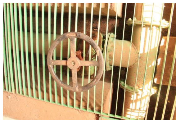
Figura 12 – Vazamento no registro na Unidade Elevatória. Contrato de Concessão 096/2014 (Data: 25/09/2019).
