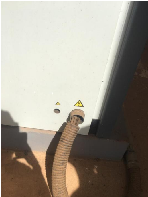
Figura 62 - Falha na proteção das instalações elétrica. NR 10 (Data: 25/10/2019)
