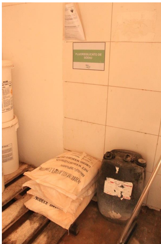
Figura 15- Armazenamento inadequado dos produtos químicos. NBR 12219-96 (Data: 25/09/2019)
