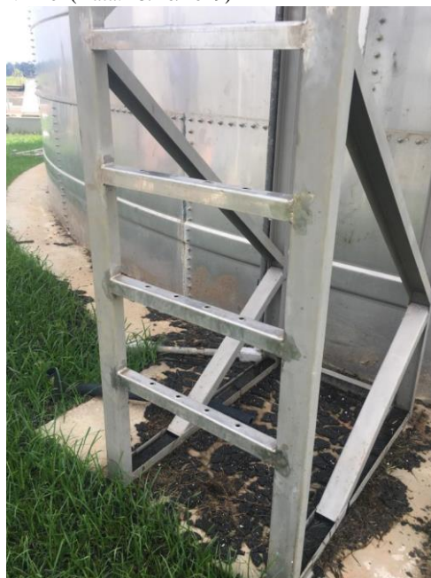
Figura 65 – Marcas de extravasamento de lodo. NBR 12208/92 (Data: 25/10/2019)
