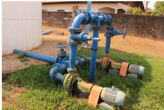
Figura 43- Drenagem inadequada de água de lubrificação de gaxetas. NBR 12214/92 (Data:30/09/2019)
