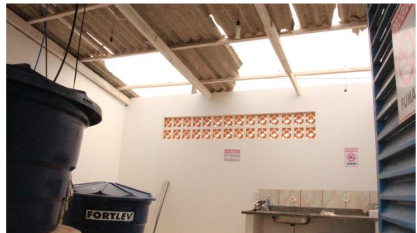
Figura 21 – Cobertura danificada do local. (Data: 26/09/2019)
