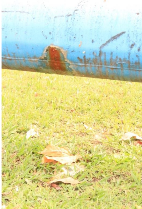
Figura 24 – Vazamento na rede de saída do reservatório 01 para a elevatória. Contrato de Concessão 096/2014 (Data: 26/09/2019)
