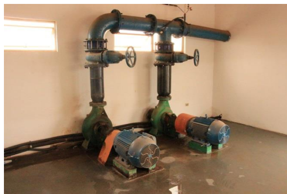
Figura 25 - Drenagem inadequada de água de lubrificação de gaxetas - NBR 12214/92 (Data: 26/09/2019)
