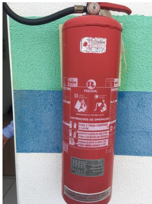
Figura 55 – Falta de sinalização do extintor de incêndios - NBR 12693/93 e NR 23 (Data: 25/10/2019)
