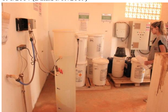
Figura 44 - Estocagem inadequada de produtos químicos. NBR 12216/92 (Data:30/09/2019)
