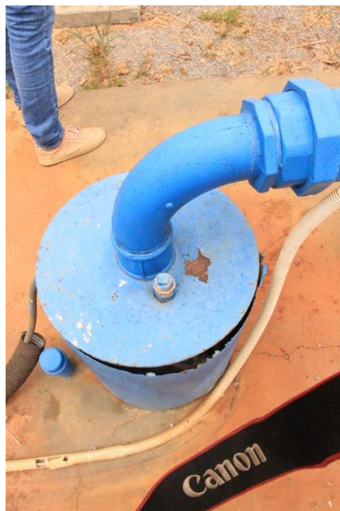
Figura 37 - Ausência do tubo de medição de nível - NBR 12212/92 (Data: 26/09/2019)
