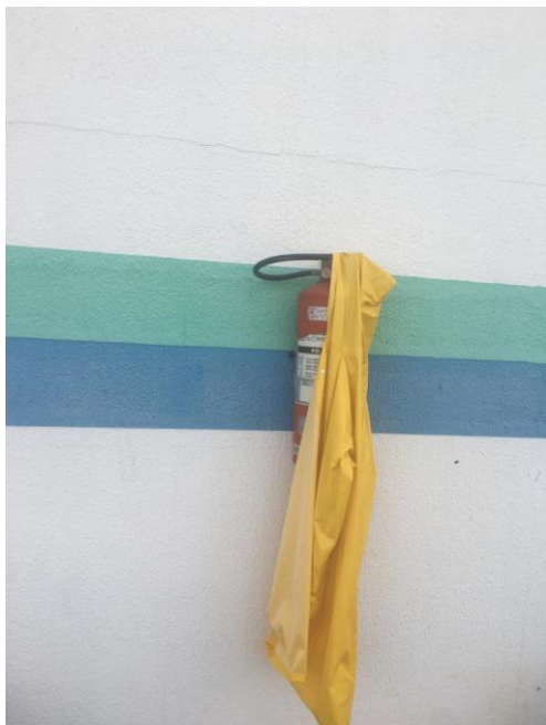
Figura 54 – Falta de sinalização do extintor de incêndios - NBR 12693/93 e NR 23 (Data: 25/10/2019)
