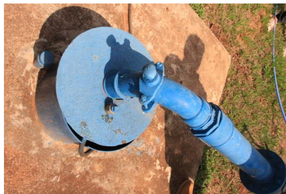
Figura 46 - Ausência do tubo de medição de nível - NBR 12212/92 (Data:30/09/2019)
