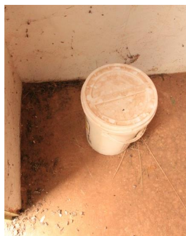
Figura 39 - Armazenagem inadequada de objetos em compartimento de instalações elétricas. NR 10 e Estocagem inadequada de produtos químicos. NBR 12216/92 (Data: 26/09/2019)
