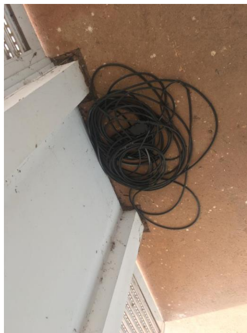
Figura 59 - Armazenagem inadequada de objetos em compartimento de instalações elétricas. NR 10 (Data: 25/10/2019)
