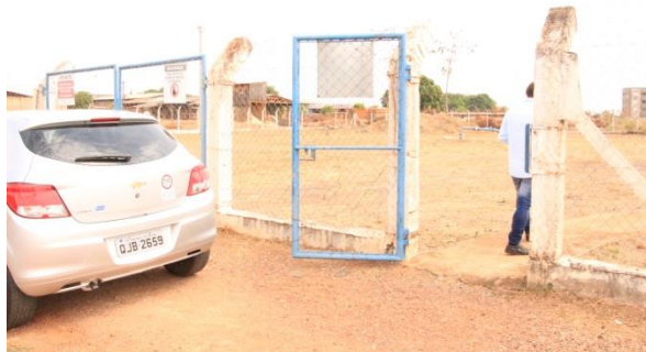
Figura 28 - Cerca de acesso violada (Data: 26/09/2019)
