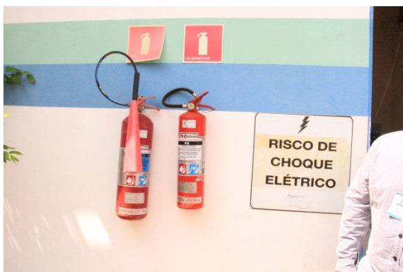
Figura 47 - Extintor em desconformidade com a norma. NR 23 (Data: 30/09/2019)
