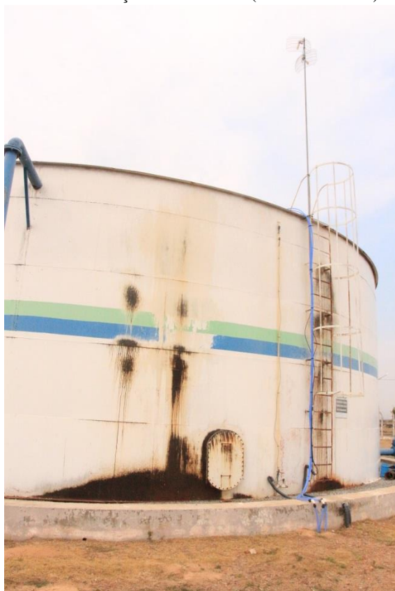
Figura 18 – Corrosão no reservatório. Contrato de Concessão 096/2014 (Data: 26/09/2019)
