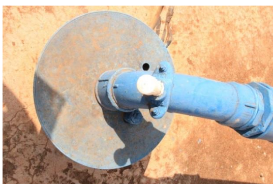
Figura 40 - Ausência do tubo de medição de nível. NBR 12212/92 (Data:30/09/2019)
