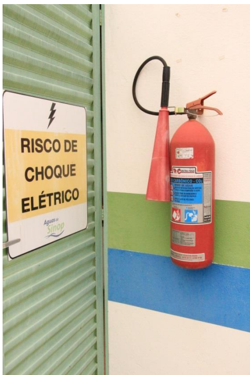
Figura 36 - Falta de sinalização do extintor de incêndio. NBR 12693/93 e NR 23 (Data: 26/09/2019)
