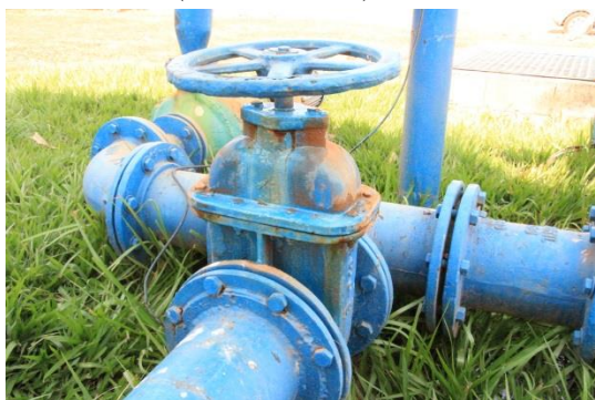
Figura 42 - Vazamento no registro. Contrato de Concessão 096/2014 (Data:30/09/2019)
