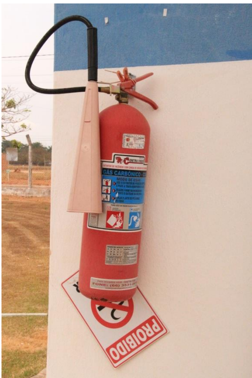
Figura 33 - Falta de sinalização do extintor de incêndio. NBR 12693/93 e NR 23 (Data: 26/09/2019)
