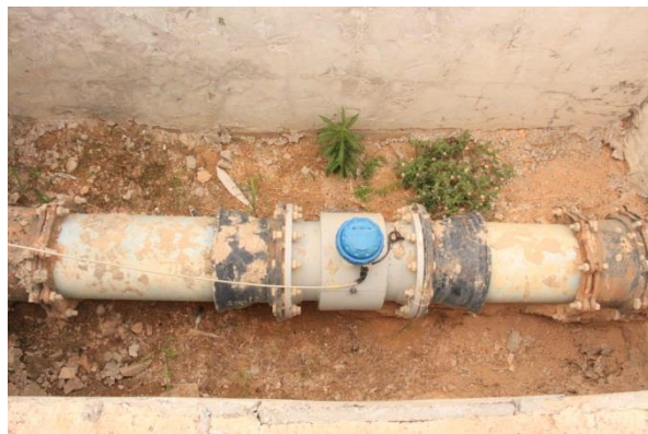
Figura 17 - Caixa do macromedidor sem proteção. (Data: 26/09/2019)
