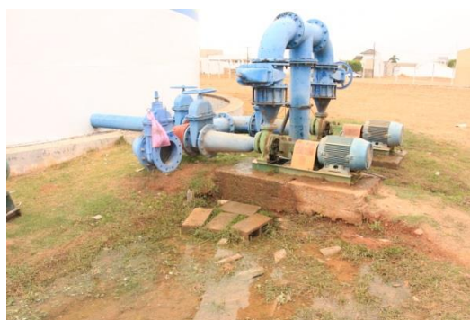
Figura 19 - Drenagem inadequada de água de lubrificação de gaxetas - NBR 12214/92 (Data: 26/09/2019)
