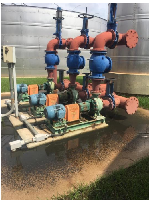
Figura 68 – Drenagem inadequada de água. NBR 12214/92 (Data: 25/10/2019)
