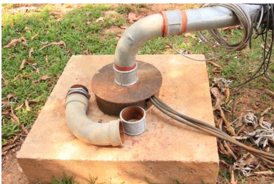
Figura 5 – Ausência do tubo medidor de nível no PTP 43 NBR 12212/92 (Data: 25/09/2019).
