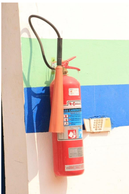
Figura 1 – Falta de sinalização do extintor de incêndios do Sistema Central. NBR 12693/93 (Data: 25/09/2019).
