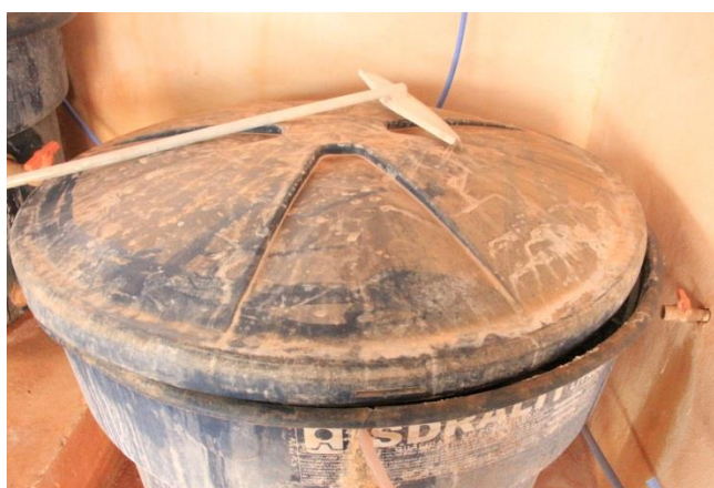
Figura 31 – Tanque de mistura aberto e armazenagem inadequada de utensílios de limpeza – NBR 12216/92 (Data: 26/09/2019)
