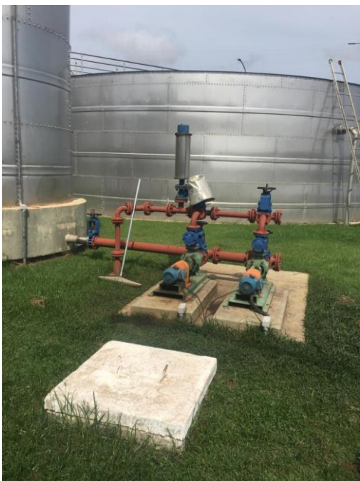
Figura 66 - Armazenamento inadequado de utensílios. (Data: 25/10/2019)
