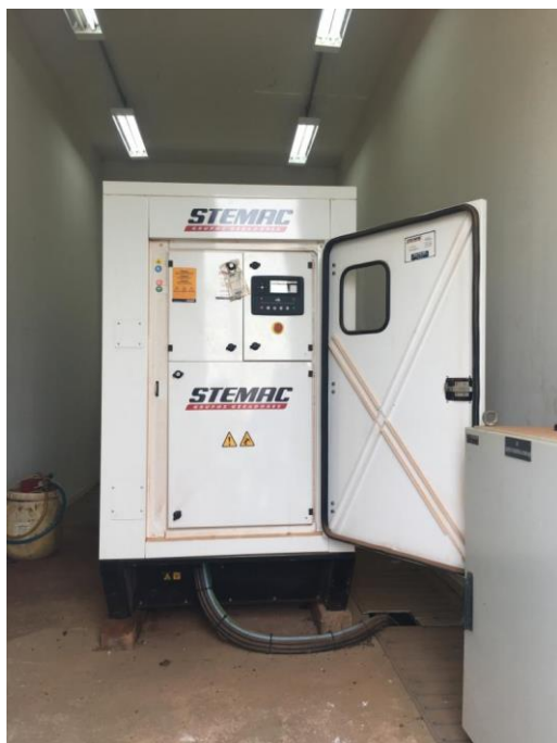
Figura 60 - Armazenagem inadequada de objetos em compartimento de instalações elétricas. NR 10 (Data: 25/10/2019)
