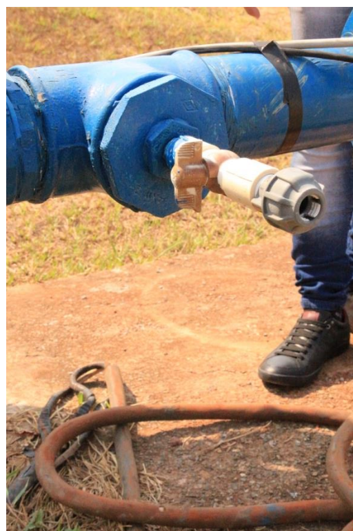
Figura 2 – Vazamento na tomada de água para a coleta no PTP 01. Contrato de Concessão 096/14 (Data:25/09/2019)
