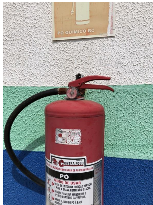
Figura 57 - Extintor despressurizado, sem lacre e trava de segurança. NBR 12962/98 (Data: 25/10/2019)
