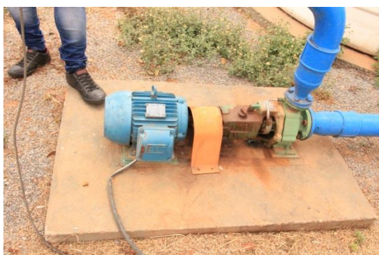
Figura 38 - Ausência do conjunto moto-bomba reserva. NBR 12214/92 (Data: 26/09/2019)
