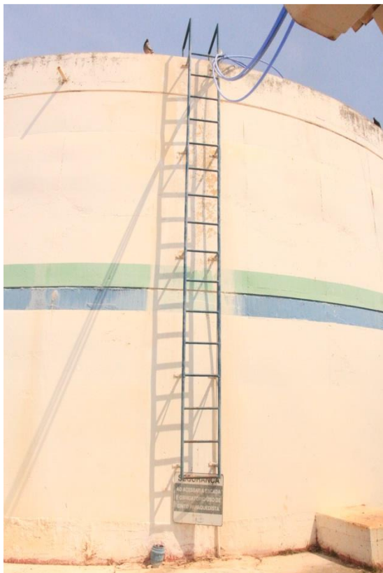
Figura 9 – Escada sem guarda-corpos. NBR 12217/94 (Data: 25/09/2019).
