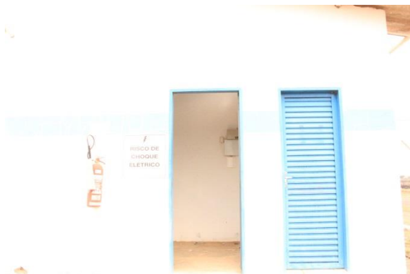
Figura 16 – Falta de sinalização do extintor de incêndios do Sistema Florença. NBR 12693/93 (Data: 26/09/2019)
