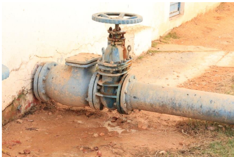
Figura 13 – Vazamento no registro de entrada da Estação Elevatória. Contrato de Concessão 096/2014 (Data: 25/09/2019)
