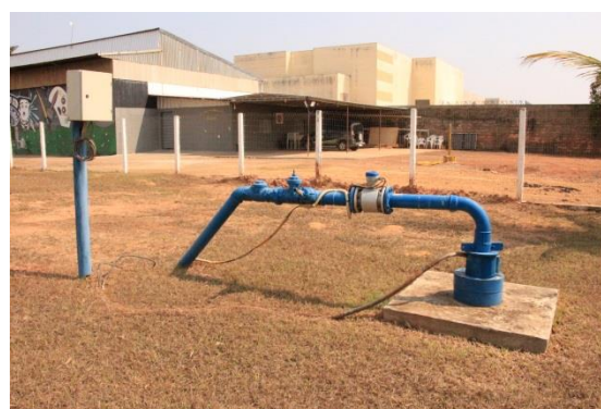
Figura 4 – Vazamento no medidor de vazão do PTP 42. Contrato de Concessão 096/14 (Data: 25/09/2019).
