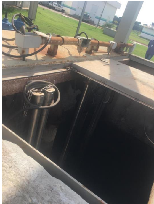
Figura 63 - Falha na proteção das instalações elétrica. NR 10 (Data: 25/10/2019)
