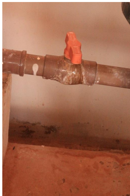
Figura 52 - Vazamento no registro que interliga os tanques de mistura. Contrato de Concessão 096/2014 (Data: 30/09/2019)
