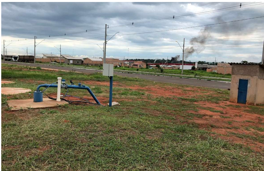
Figura 1 - Ausência de isolamento da área, de placa de identificação e alerta de restrição de uso e de iluminação noturna (Data: 16/12/2019).
