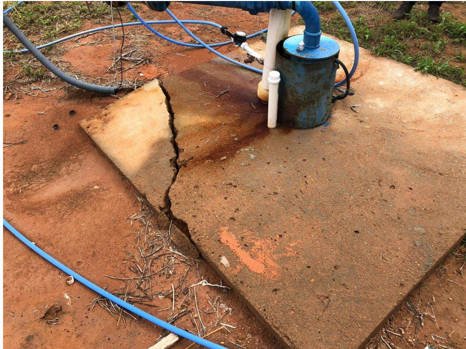
Figura 11 - Más condições de conservação da laje de concreto (Data: 16/12/2019).
