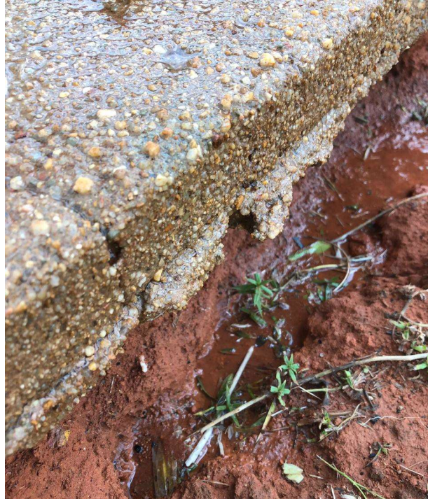
Figura 3 - Vazamento de água (Data: 16/12/2019).
