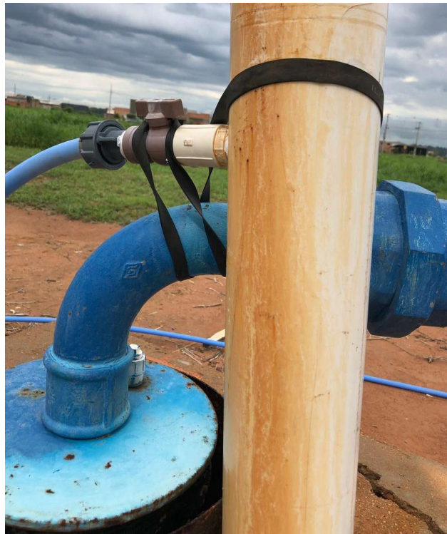
Figura 10 - Más condições das instalações hidráulicas (Data:16/12/2019).
