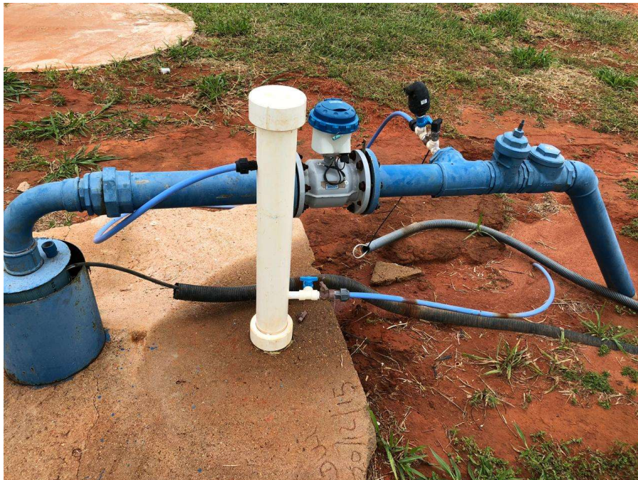
Figura 5 - Instalações elétricas fora do padrão NR 10 (Data 16/12/1990).
