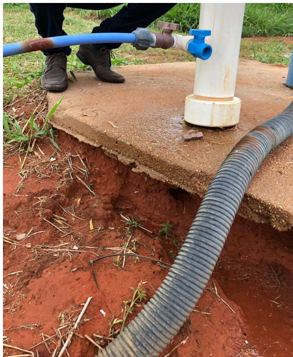
Figura 4 - Más condições da laje de concreto e erosão no solo (Data: 16/12/2019).
