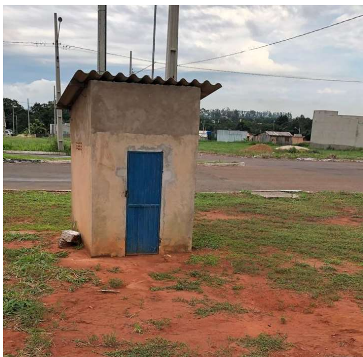
Figura 2 - Ausência de extintor de incêndio e alerta de restrição e uso (Data: 16/12/2019).
