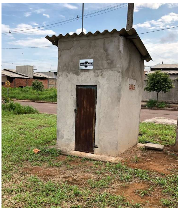
Figura 8 - Ausência de extintor de incêndio e alerta de restrição e uso (Data: 16/12/2019).
