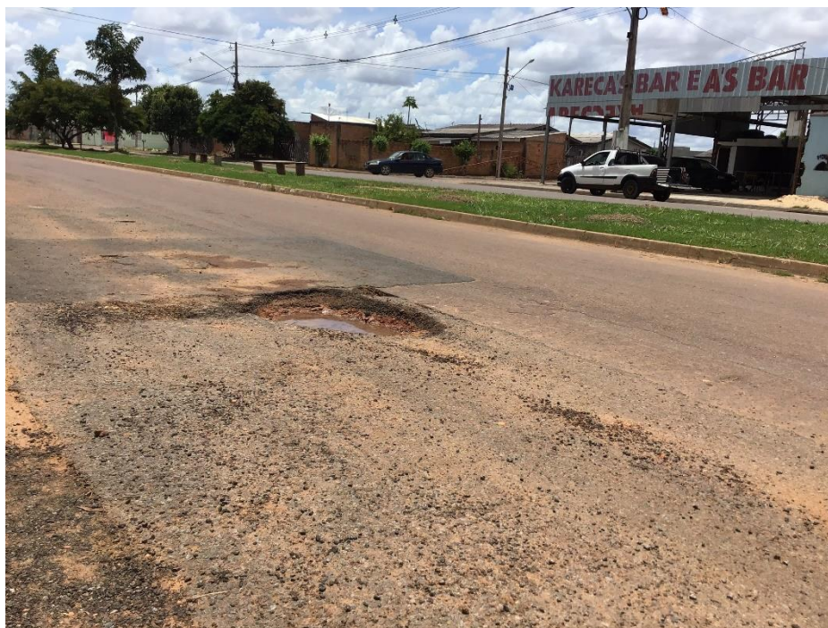
Figura 2 - Repavimento danificado na Avenida José Naeno, cruzamento com a Rua Nicolau Flessak, em frente ao Kareca's Bar (Data: 31/01/2020).
