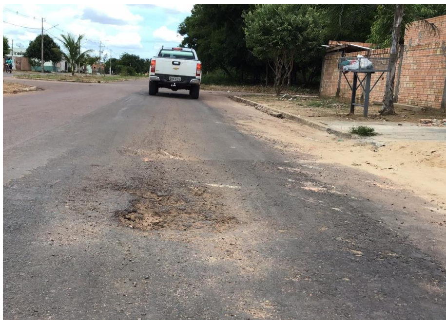
Figura 1 - Repavimento danificado na Avenida José Naeno, próximo ao cruzamento com a Rua Alcidez Faganelo (Data: 31/01/2020)
