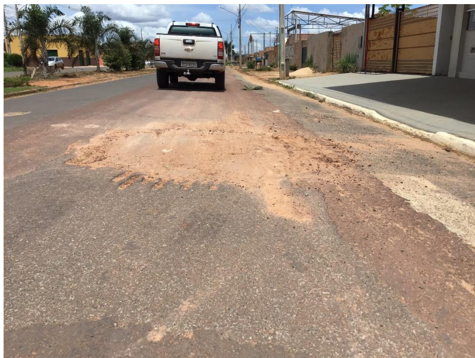
Figura 4 – Repavimento danificado na Avenida José Naeno, cruzamento com a Rua 2, em frente à Igreja Sara Nossa Terra (Data: 31/01/2020).
