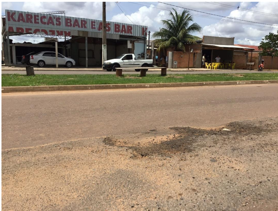
Figura 3 - Repavimento danificado na Avenida José Naeno, cruzamento com a Rua Nicolau Flessak, em frente ao Kareca's Bar (Data: 31/01/2020).
