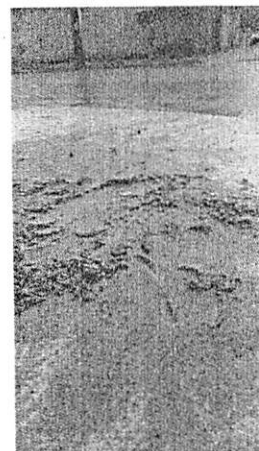
PV na esquina da Rua Bracatingas com Pacaris: PV totalmente concretado e selado – não é possível realizar manutenção
