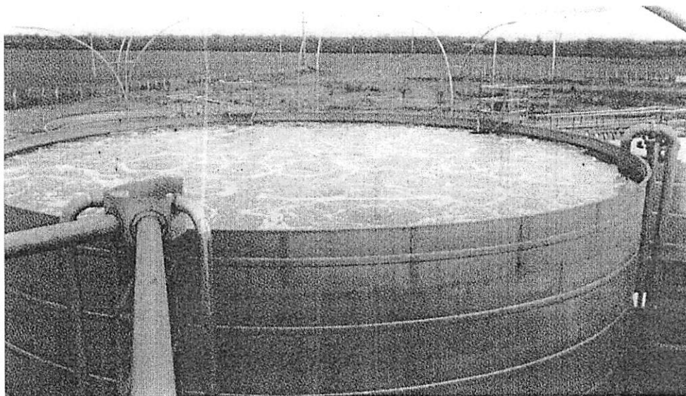
Figura 10 - Tanque aerado em funcionamento
