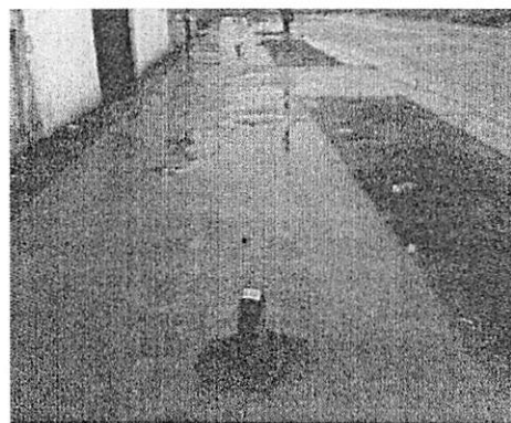
TIL sem acabamento no Bairro Oliveiras
