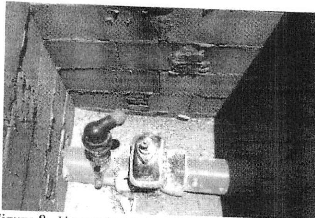
Figura 8. Ventosa instalado ao lado do registro de rede
