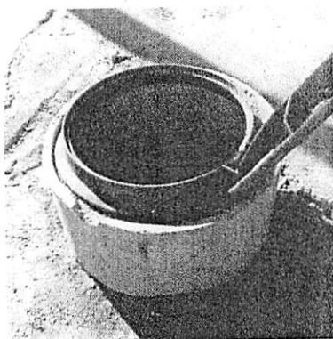
PV na esquina da Rua Cravos com Av. dos Pinheiros: Sem padronização e nivelamento
