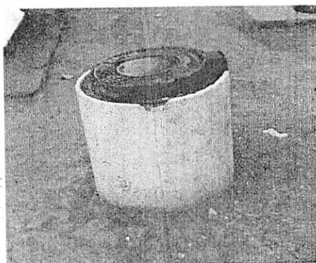
PV na Av. dos Pinheiros: Sem padronização e nivelamento
