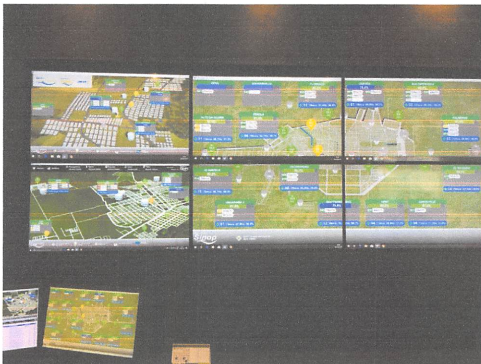
Figura 6 - Centro de Controle Operacional.
