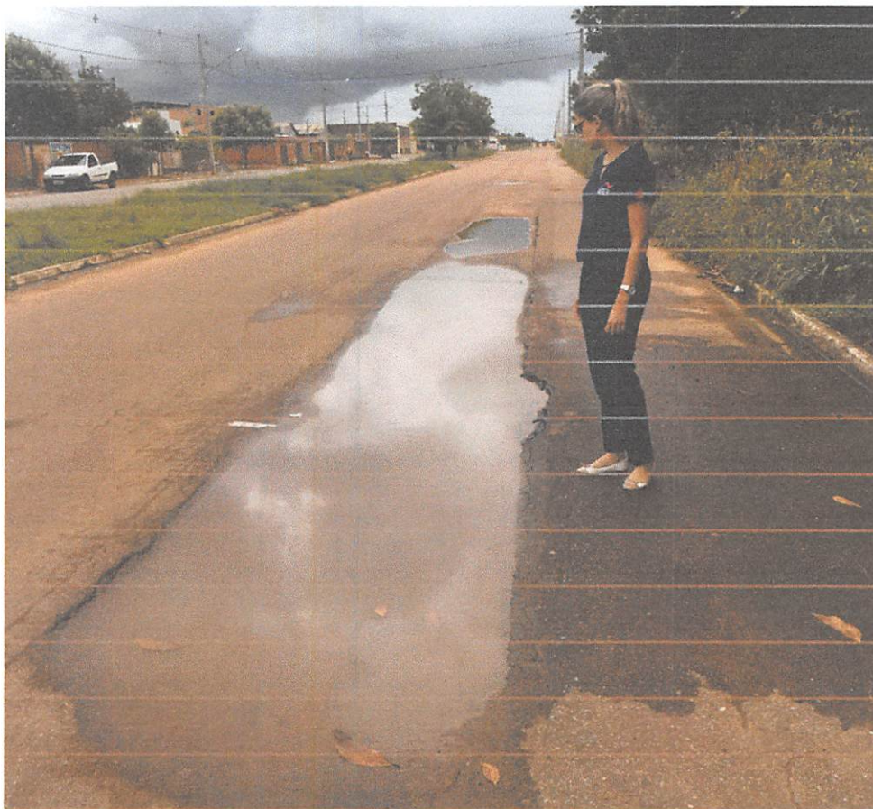
Figura 1 – Depressão no asfalto ocorrida na Av. José Naeno (Data: 01/03/2019).
